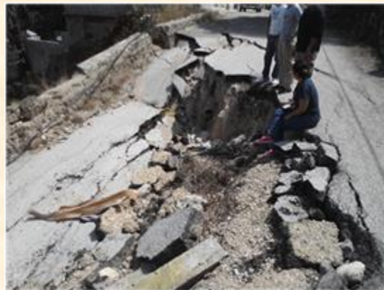
Fotografía 5. Segundo hundimiento en la calle Señor del pozo
