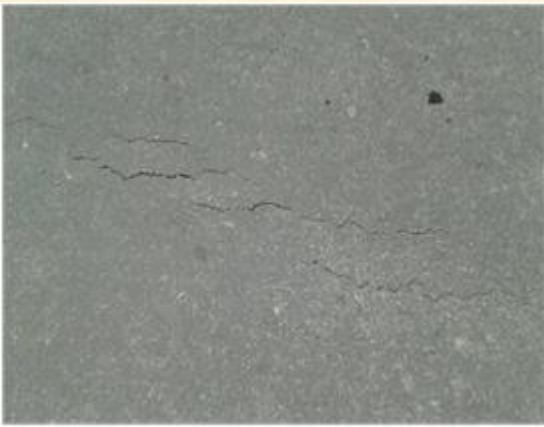
Fotografía 9. Grietas de la calle "Señor del pozo"
