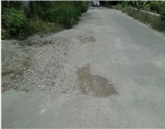
Fotografía 10. Hundimientos en la zona
