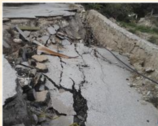
Fotografía 3. Primer deslizamiento de la calle "Señor del pozo"
