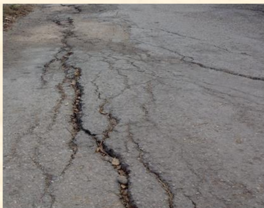
Fotografía 1. Grietas presentadas en la calle
