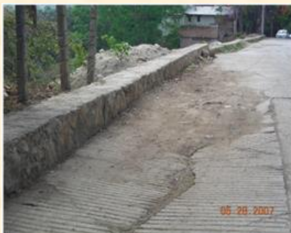
Fotografía 2. Hundimiento de la zona
