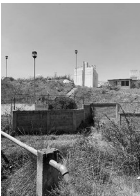
Imagen 3 Foto de Planta de tratamiento de agua residual (PTAR) de la comunidad, que no está en funcionamiento.
